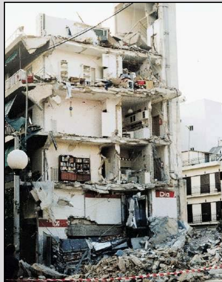
Βλάβες σε οικοδομή στην Αθήνα από το σεισμό της 7ης Σεπτεμβρίου 1999 (ΟΑΣΠ).
