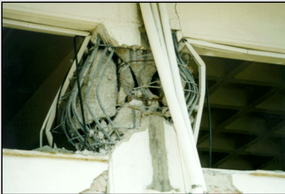
Αστοχία κολώνας 5όροφης οικοδομής στην περιοχή των Άνω Λιοσίων (έτος κατασκευής 1997) που προκλήθηκε από το σεισμό της 7ης Σεπτεμβρίου 1999 ( M=5.9 ) (Anastasiadis et al., 1999).
