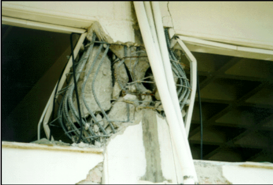
Αστοχία κολώνας 5όροφης οικοδομής στην περιοχή των Άνω Λιοσίων (έτος κατασκευής 1997) που προκλήθηκε από το σεισμό της 7ης Σεπτεμβρίου 1999 ( M=5.9 ) (Anastasiadis et al., 1999).
