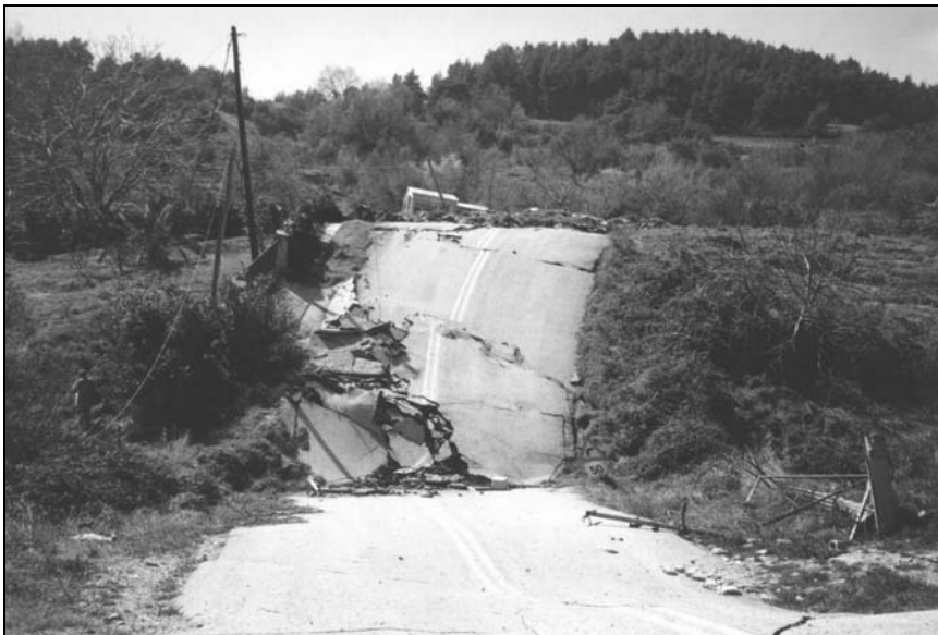
Σχήμα 1. Αναθόλωση των εδαφικών μαζών στη στροφή του αυτοκινητόδρομου με έντονη παραμόρφωση και μεταβολή της μορφολογίας.
