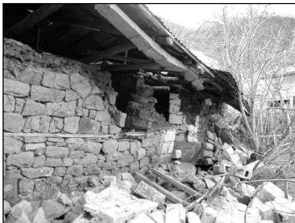
Σχήμα 6. Κατεστραμμένη οικία μέσα στη ζώνη των κύριων αστοχιών του οικισμού.
